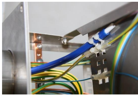
Nylon-putki estää kaapelin keskiputken lommahtamisen, kun jatkoslevy on pystyasennossa
